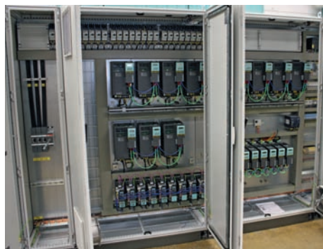
Apparatskåp till Osborn International för en ytbehandlingsmaskin till en slutkund inom metallbearbetningsindustrin.
