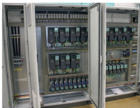
Apparatskåp till Osborn International för en ytbehandlingsmaskin till en slutkund inom metallbearbetningsindustrin.
