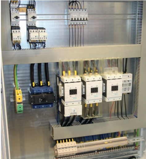
Elskåp med kontaktorer, motorskydd, säkringar och överlastrelä till Rapid Granulator för en granuleringsmaskin.
